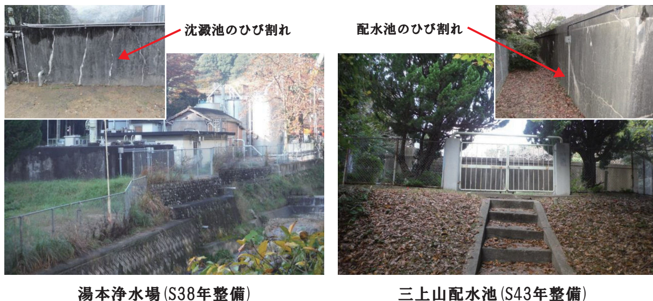
図12 老朽化施設の様子
