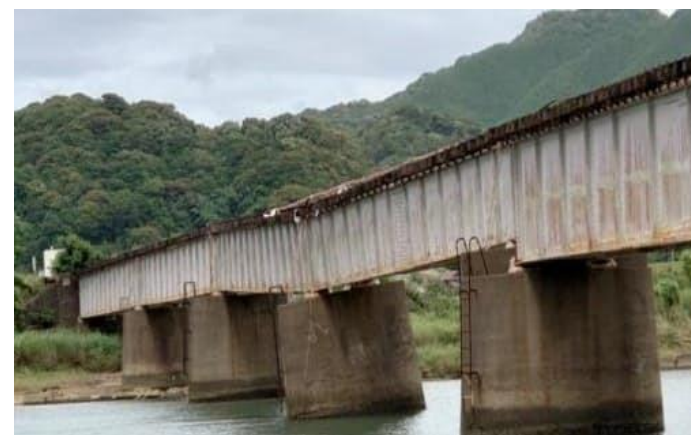
JR山陰本線栗野川橋りょうの被害 (令和5年6月)
