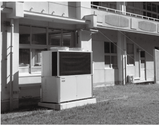
▼通小カスヒートポンプエアコン設備
