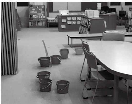
▼仙崎小学校図書室の雨漏り対策
